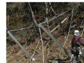
バックステーケーブルで支柱を固定するため、地山に対し垂直に支柱を設置できます。
